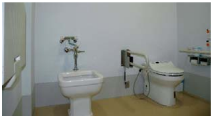
オストメイトを備えた多目的トイレ
