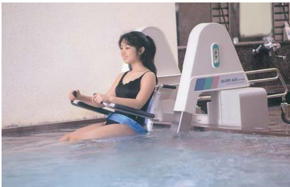
車いす入浴システムが設置されている高山グリーンホテルの温泉施設
